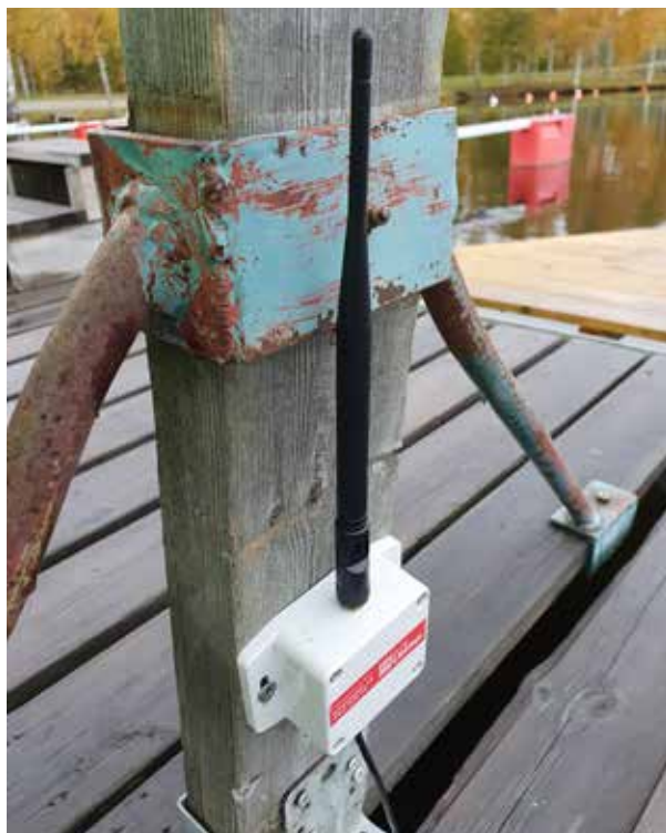
Sensorn på bryggan tar emot data från sensorn i vattnet för att på så sätt mäta aktuell badtemperatur.
